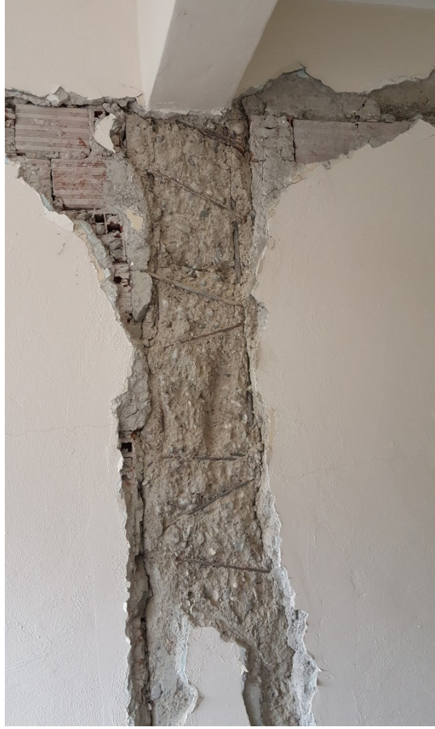
Şekil 25. Belediye binası, zemin kat kolonu. Düzensiz, özensiz donatı yerleşimi, düşük beton dayanımı. Kolon betonu (!) elle ufalanabilen kum yığını şeklinde görülmektedir.
