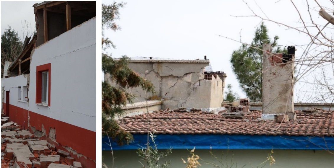
Şekil 29. Kalkan duvar ve baca hasarları
