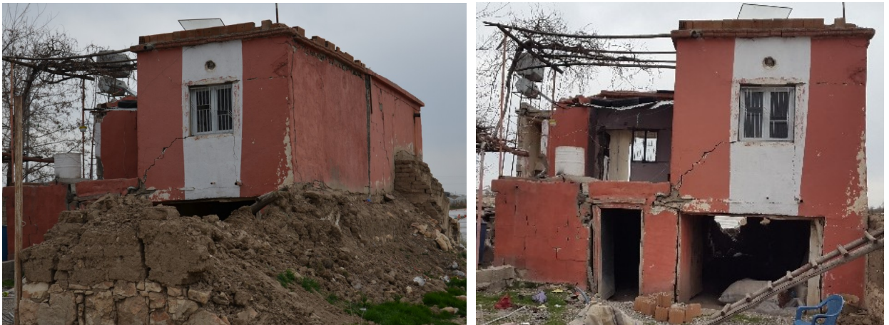
Şekil 37. Taşkuyu köyünde karma(!) yapım tekniği ile inşa edilmiş ve ağır hasarlı/yıkık yapı
