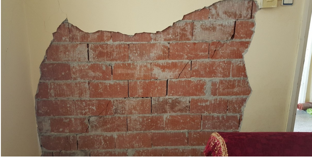
Şekil 28. Taşıyıcı duvarlarda kayma hasarları. Düşey derzlerde bağlayıcı kullanılmamış.
