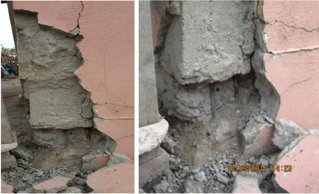
Şekil 26. Temel kirişi düşey hatıl birleşimi. Temel kirişinde düşük beton dayanımı ve dağılma
