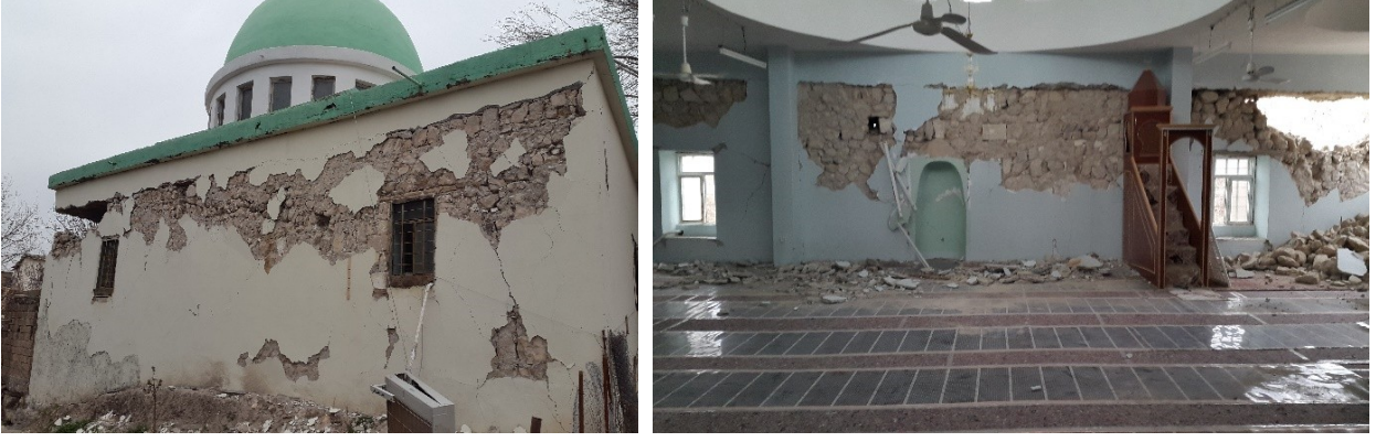
Şekil 36. Moloz taşlar ve kil toprak bağlayıcı duvarlar ve betonarme kubbe/tavan döşemesi ilave edilen, ağır hasar gören Taşkuyu Köyü camisi.
