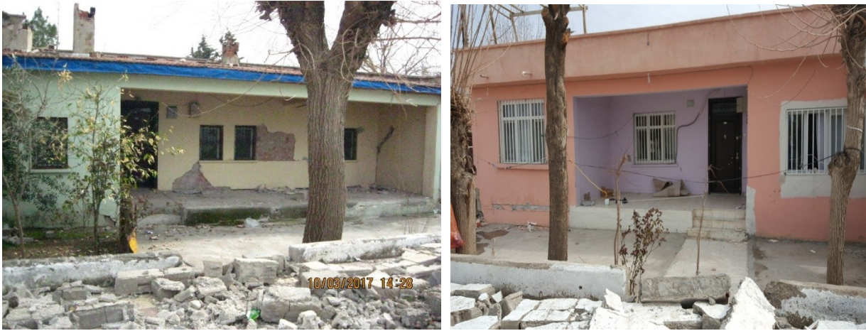
Şekil 30. Yapıda pencere, kapı boyutlarının ve yerlerinin değiştirilmesi, betonarme döşeme ve parapet ilaveleri taşıyıcı duvarların hasarlarına neden olmuştur.
