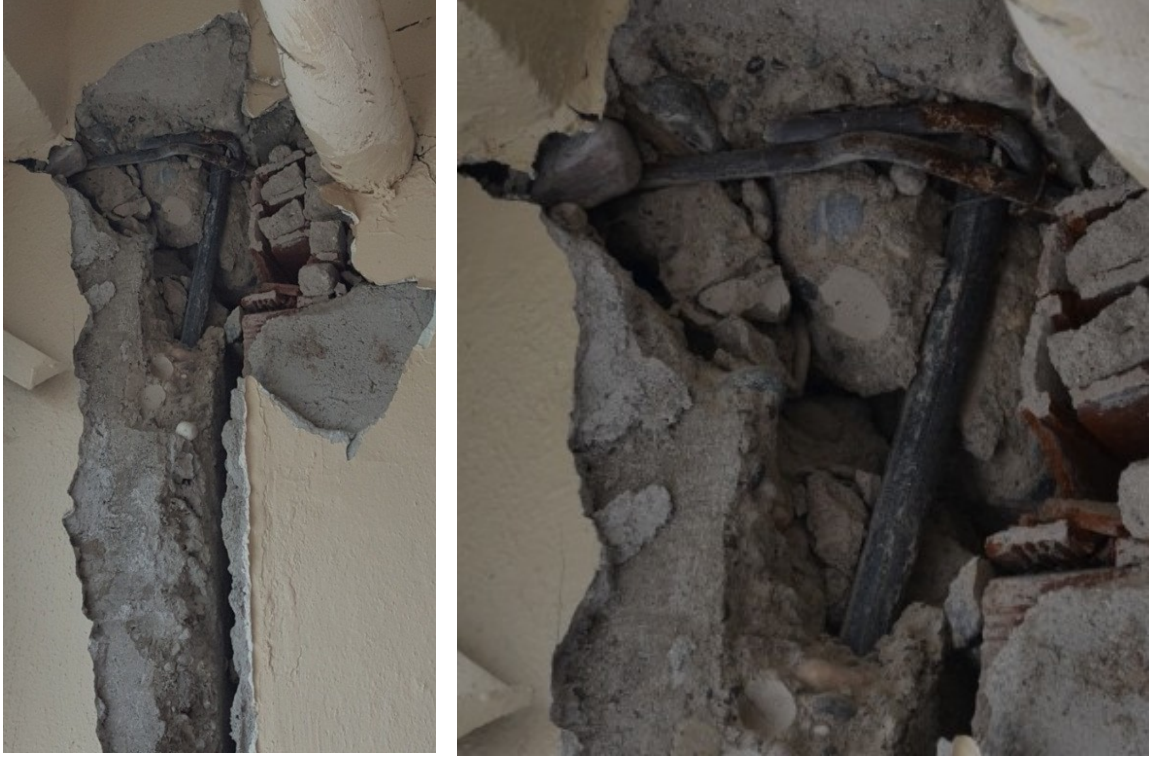
Şekil 23. Belediye Binası, birinci kat kolon ucunda mafsallaşma. Yetersiz etriye aralığı, etriye ucunda açılma, beton içinde iri agregalar ve betonda dağılma açıkça görülmektedir.
