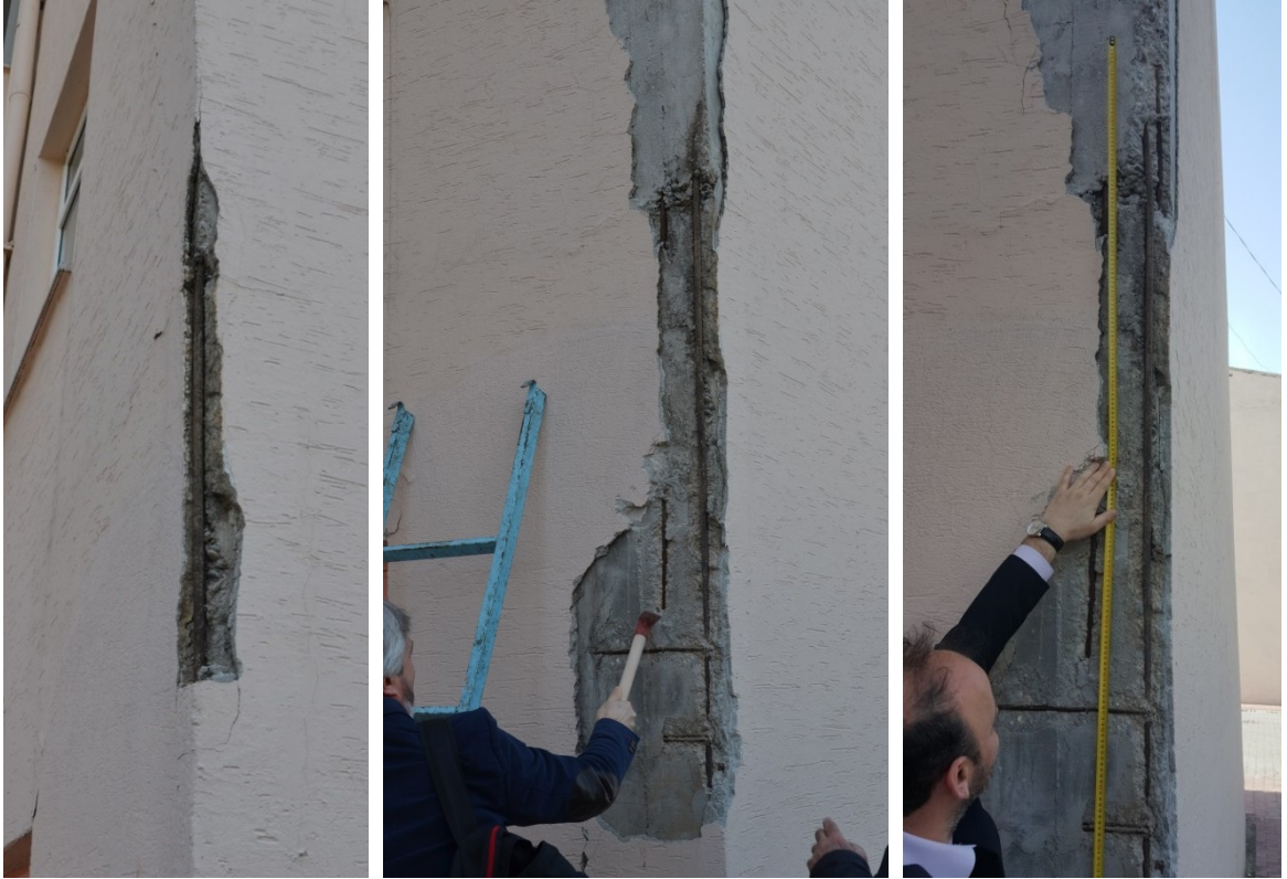
Şekil 13. Perde uç bölgesinde sargısız alan, yetersiz paspayı ve korozyon
