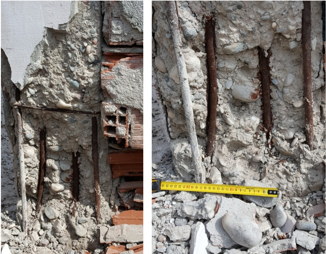
Şekil 24. Belediye Binası, temel üst kotunda mafsallaşan kolon ucu. Yetersiz etriye aralığı, boyuna donatılarda eğilme ve korozyon, beton içinde 100 mm boyutuna varan iri agregalar.
