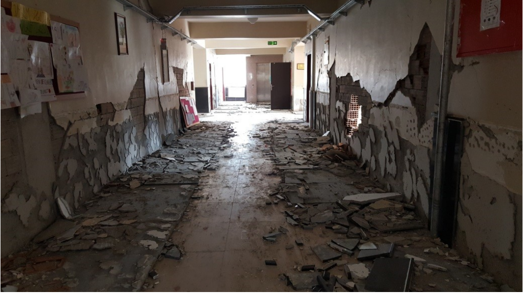
Şekil 20. Anadolu İmam Hatip Ortaokulu birinci kat koridorundaki yapısal olmayan hasarlar
