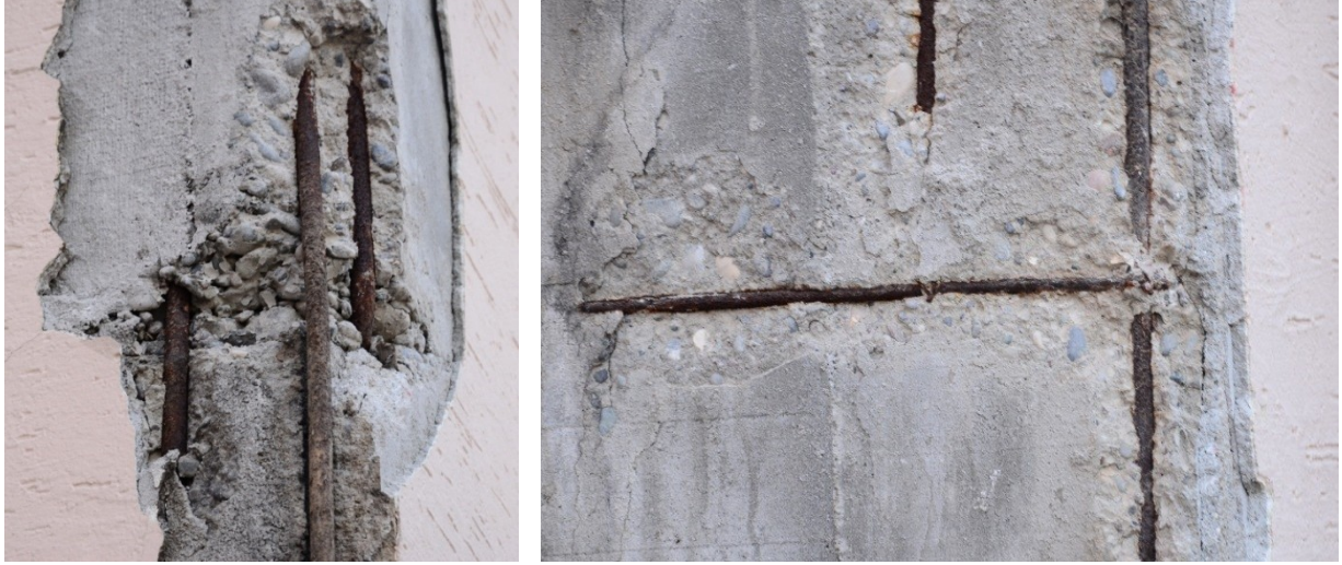
Şekil 14. Perde uç bölgesinde sargısız alan, yetersiz paspayı ve korozyon
