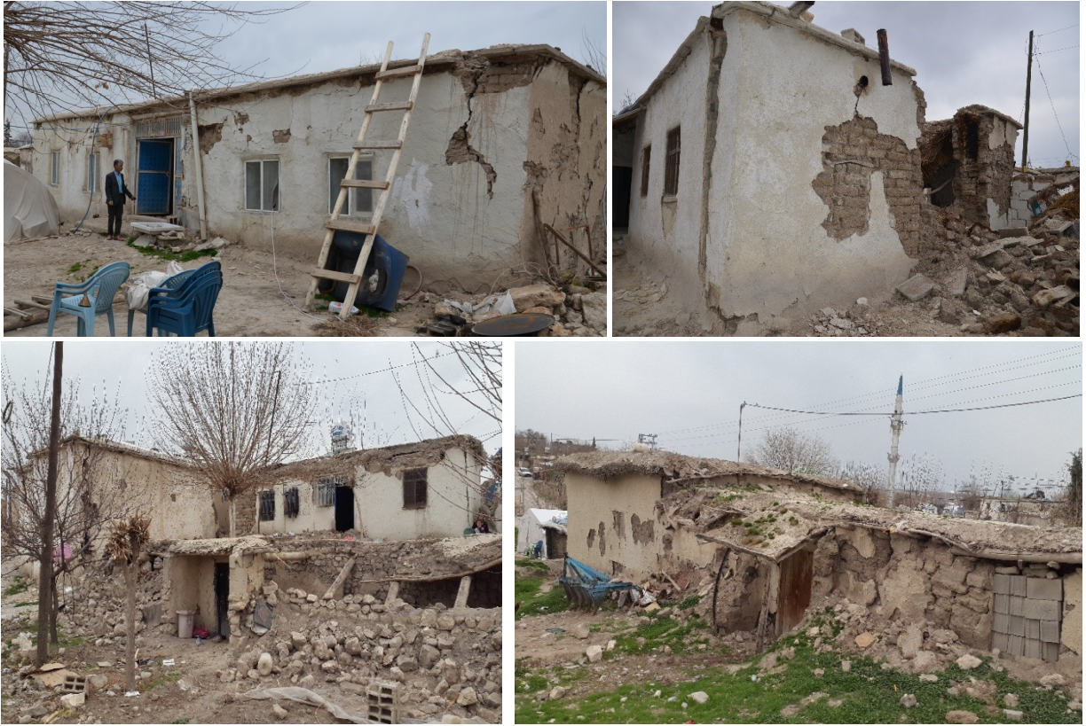
Şekil 33. Kerpiç yapılarda gözlenen deprem hasarları ve zamana, iklim şartlarına bağlı bozulmalar.
