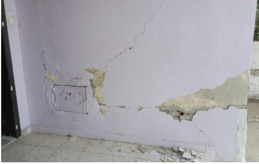
Şekil 32. Su tesisatı yerleştirmek amacı ile duvarda kesit azalması ve yapısal hasarlar.
