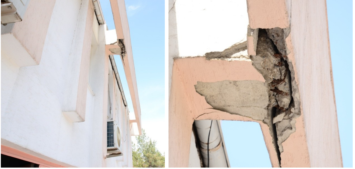
Şekil 18. Arka cephede mimari eleman olarak düzenlenen giriş üzerindeki hasarlar
