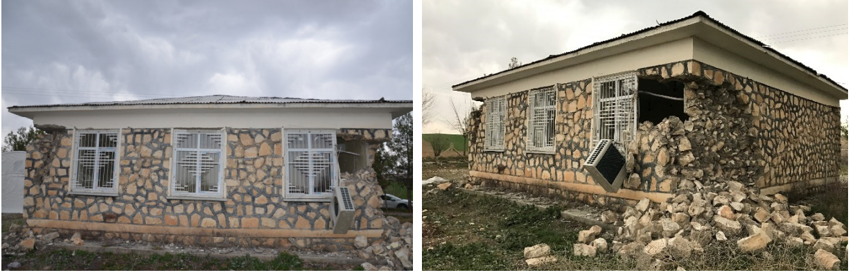
Şekil 34. Akdamar köyü Taziye Evi. Yapım kurallarına uyulmaması ve yetersiz bağlayıcıdan kaynaklı ağır yapısal hasarlar.
