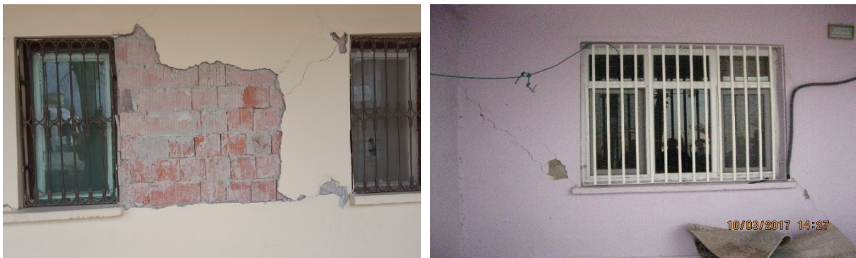
Şekil 31. Taşıyıcı dış duvarlarda pencere kenarlarında ortaya çıkan kayma çatlakları
