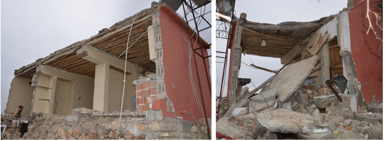
Şekil 38. Plansız ve farklı malzemeler ile yapılmış ağır hasarlı/yıkık yapı
