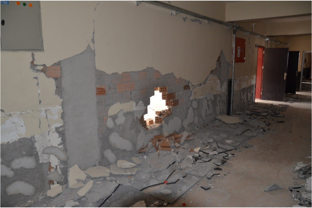
Şekil 21. Samsat Anadolu İmam Hatip Ortaokulunda duvar hasarları
