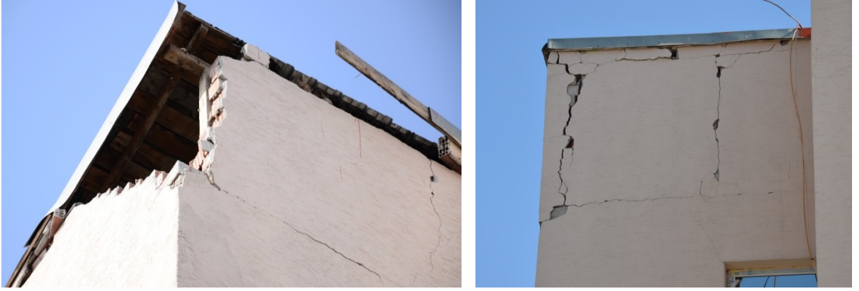
Şekil 12. Kalkan duvar hasarları
