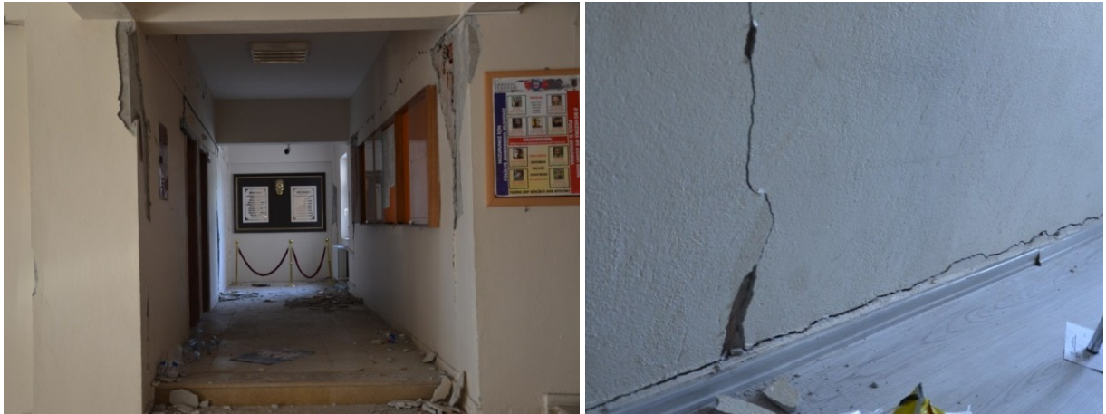
Şekil 11. Çerçeve duvar birleşimlerinde gözlenen hasarlar
