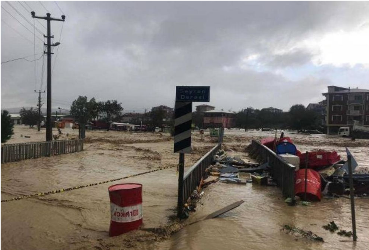
Şekil 9- Taşkın ile taşınan malzemelerle tıkanmış olan 2. Köprü
